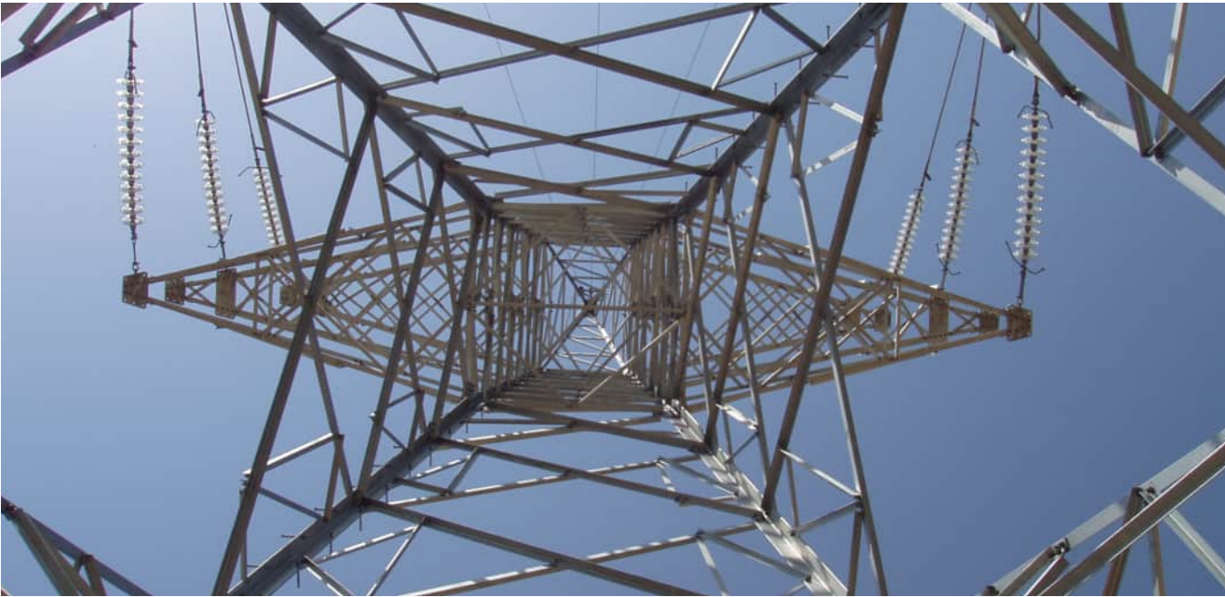
Hauptschutz für Leitungen bis 110 kV
